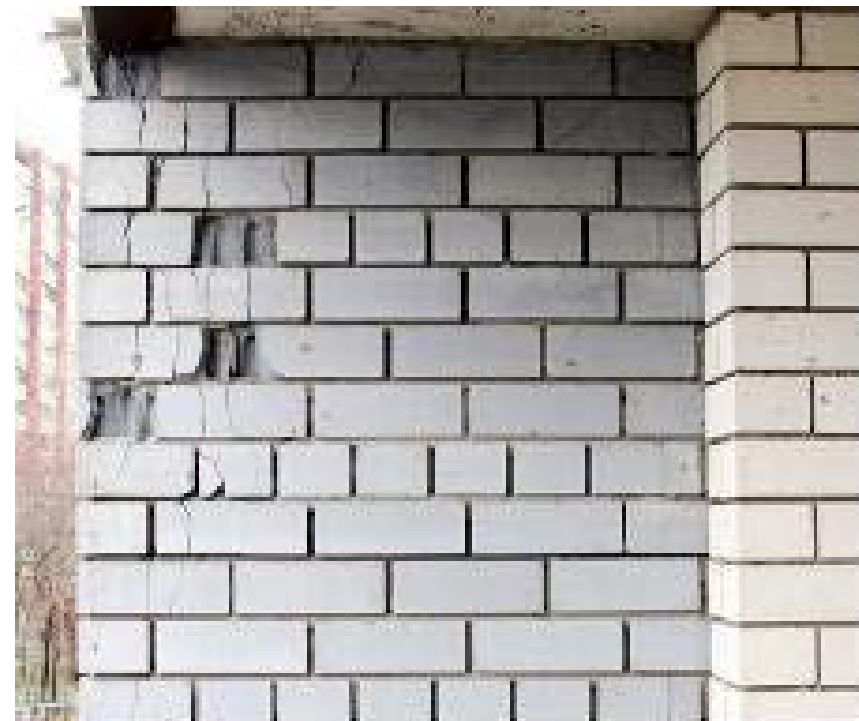
Разрушение участка кирпичной кладки под местом опирания опорного металлического уголка ограждения и перекрытия лоджий со следующими повреждениями: многочисленные вертикальные и наклонные трещины шириной раскрытия до 5,0мм, пересекающие до 12-ти рядов кладки; скалывания и отслоения лещадок отдельных кирпичей; отдельные вертикальные трещины шириной раскрытия до 1,0мм, пересекающие до 4-х рядов кладки и расположенные с шагом 0,25-0,60м по боковым граням пилонов
