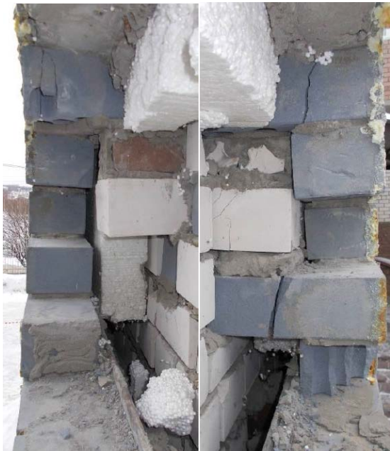
Вертикальные трещины в диафрагмах шириной раскрытия до 5 мм
