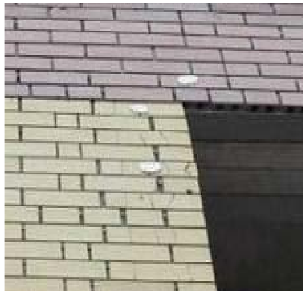
Вертикальные и наклонные трещины шириной раскрытия до 3 мм, которые пересекают до девяти рядов кладки
